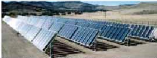
Figur 8: ENTECH's 100-kilowattsystem med fresnellinser i Fort Davis, Texas.
