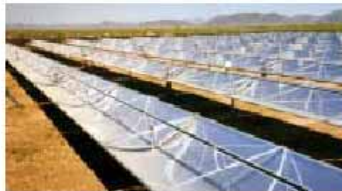
Figur 9: Koncentrerande solfångaranläggning som förvärmer varmvatten till ett fängelse i Arizona.
